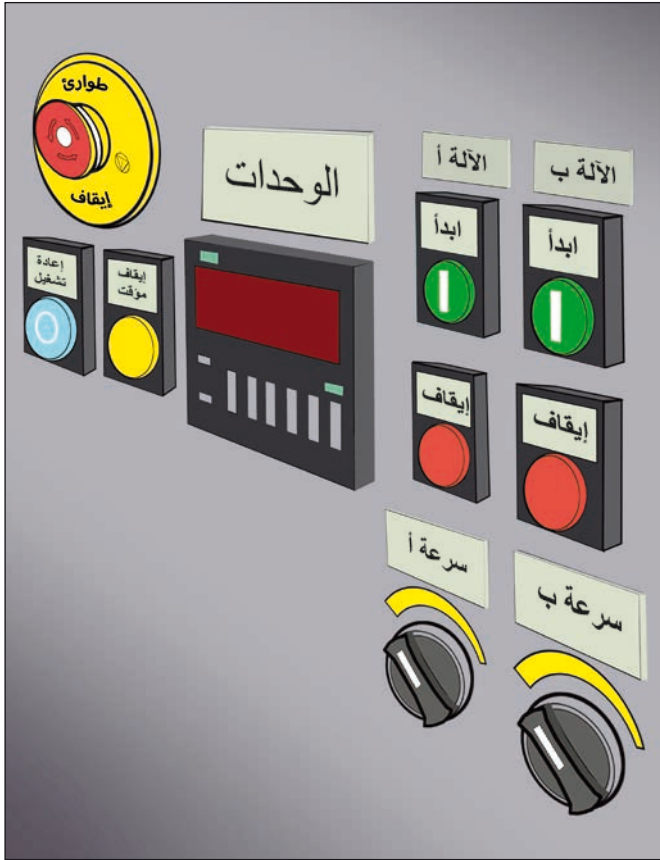
الشكل 40 - ت. لوحة كهربائية تتضمن وسائل التحكم والمفاتيح ووسائل الإظهار، وجميعها مرئية وموسومة بوضوح باللغة المحلية.
